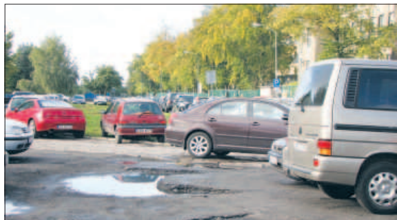
Na razie przed szpitalem przy ul. Unii Lubelskiej trzeba nadal uważać, by nie wpaść w koleiny i doły.
